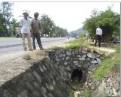
Cống qua đường giao dân sinh quá nhỏ, thoát nước không kịp, nước chảy tràn qua đường tại Km1265+430 QL1
