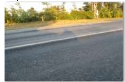
Mặt đường lún vết bánh xe tại Km636+100 QL1
