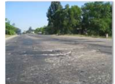
Mặt đường BTXM bị vỡ tại Km 707 QL1
